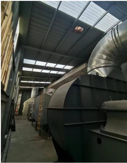
3#废气处理设施
