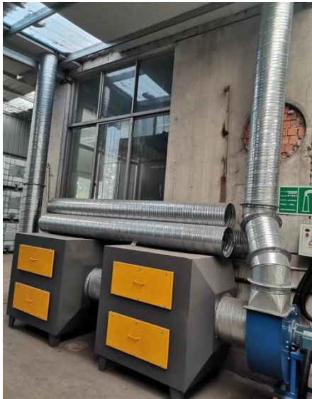
4#废气处理设施
