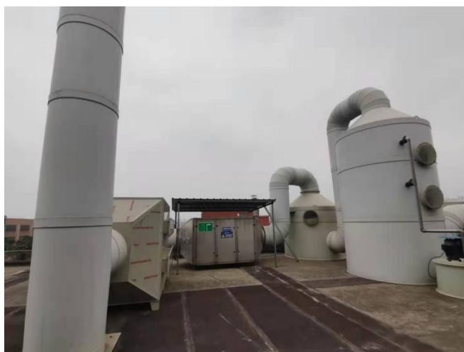
5#废气处理设施
